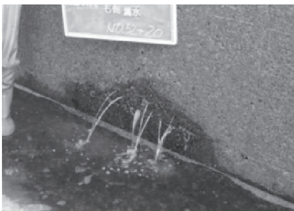
写真5 コンクリートのひび割れからの漏水
