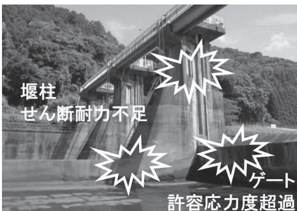
写真4 頭首工の耐震性不足
